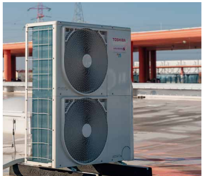
PADO bevásárlóközpont, Parndorf, CAVERION Österreich GmbH (Klímaberendezések és hőszivattyúk)
